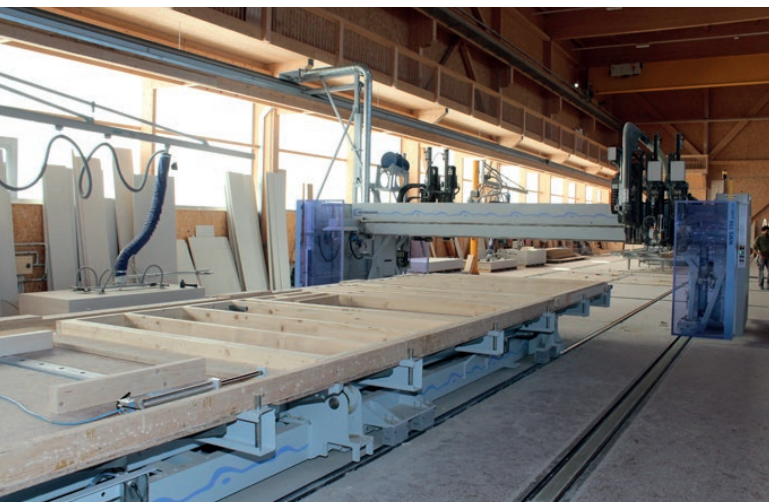
Vista de la instalación completa en la nueva nave de producción de Krattiger Holzbau AG en Amriswil.
